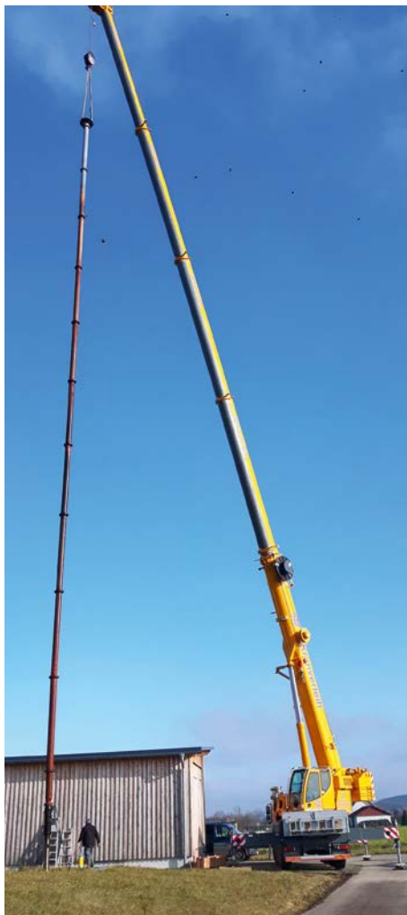
Eine Grundwasserpumpe in der Haidgauer Heide wurde im Jahre 2017 erneuert. Foto: osg
