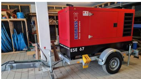
Eines der vier mobilen Stromaggregate. Foto: OSG
